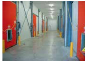
Atmosfer Kontrollü Soğuk Odalar Controlled Atmosphere Cold Rooms
